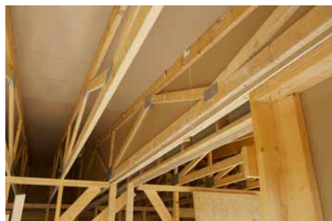
En brannskillevegg er ført helt opp under undertaket på loftet. Over denne, usynlig på bildet mellom under- og overtaket, ligger en hulromsventil med brannstoppmateriale i begge sylindrene.
