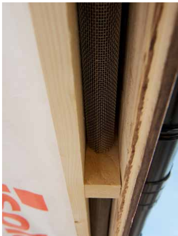
Mellom raftekassas to forkantbord er det en åpning for lufting. Her ligger hulromsventilen som ved brann tetter åpningen og hindrer brannspredning opp til loftet.
